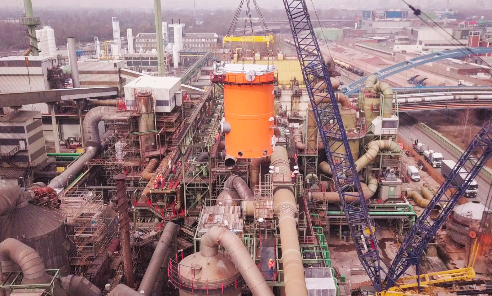
250t schwer, 18m hoch und ein Außendurchmesser von 6m: Der Zwischenabsorber, das „Herz“ der Fernwärme, steht an seinem Platz auf dem Aurubis-Werksgelände. In diesem zylindrischen Behälter entsteht die praktisch CO 2 -freie Wärme, mit der zukünftig der neue Stadtteil beheizt werden soll.
